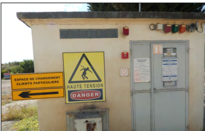
Exemple de protections et mises en garde contre le risque électrique (détaillé en Figure 5)
